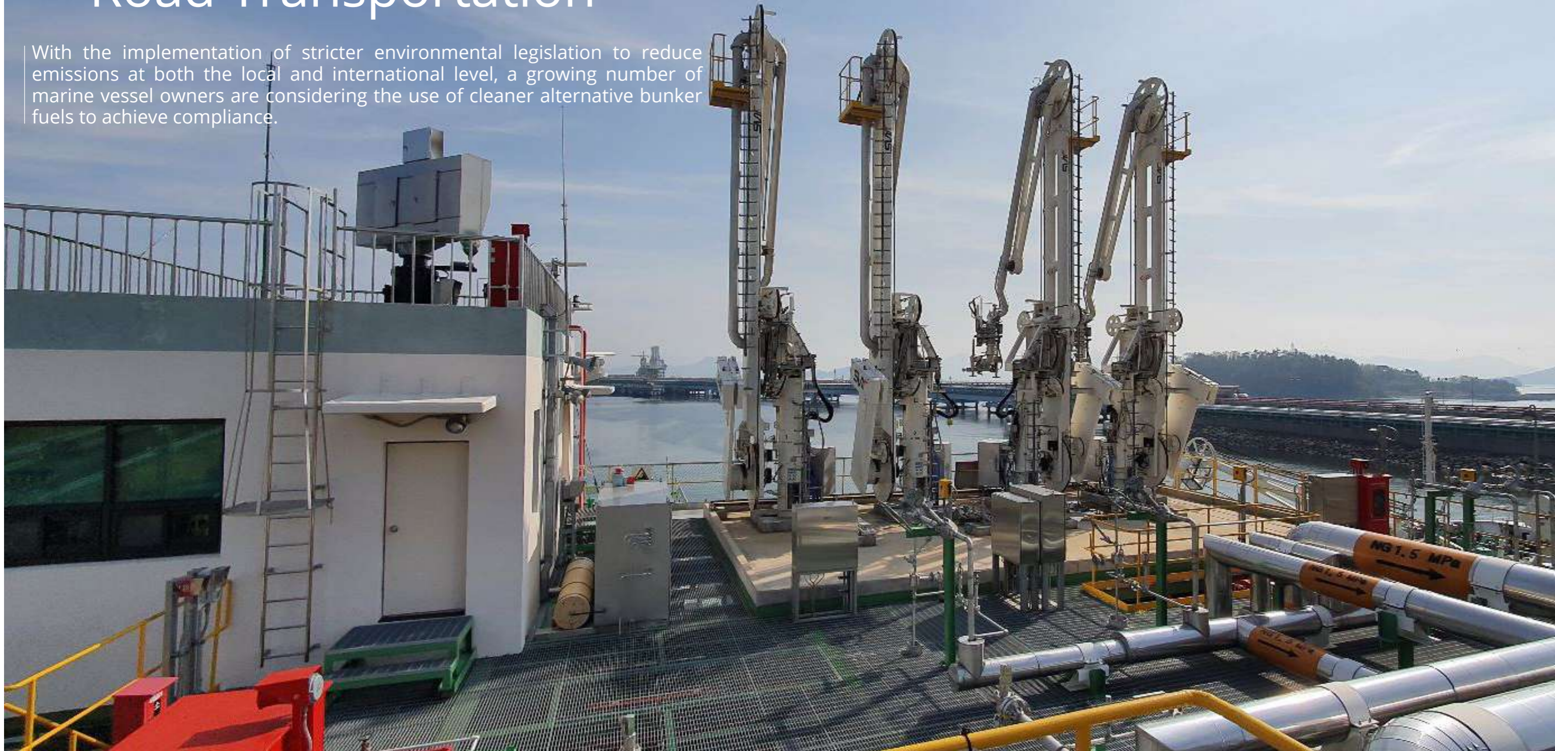
Incheon LNG Terminal - Courtesy of KOGAS
