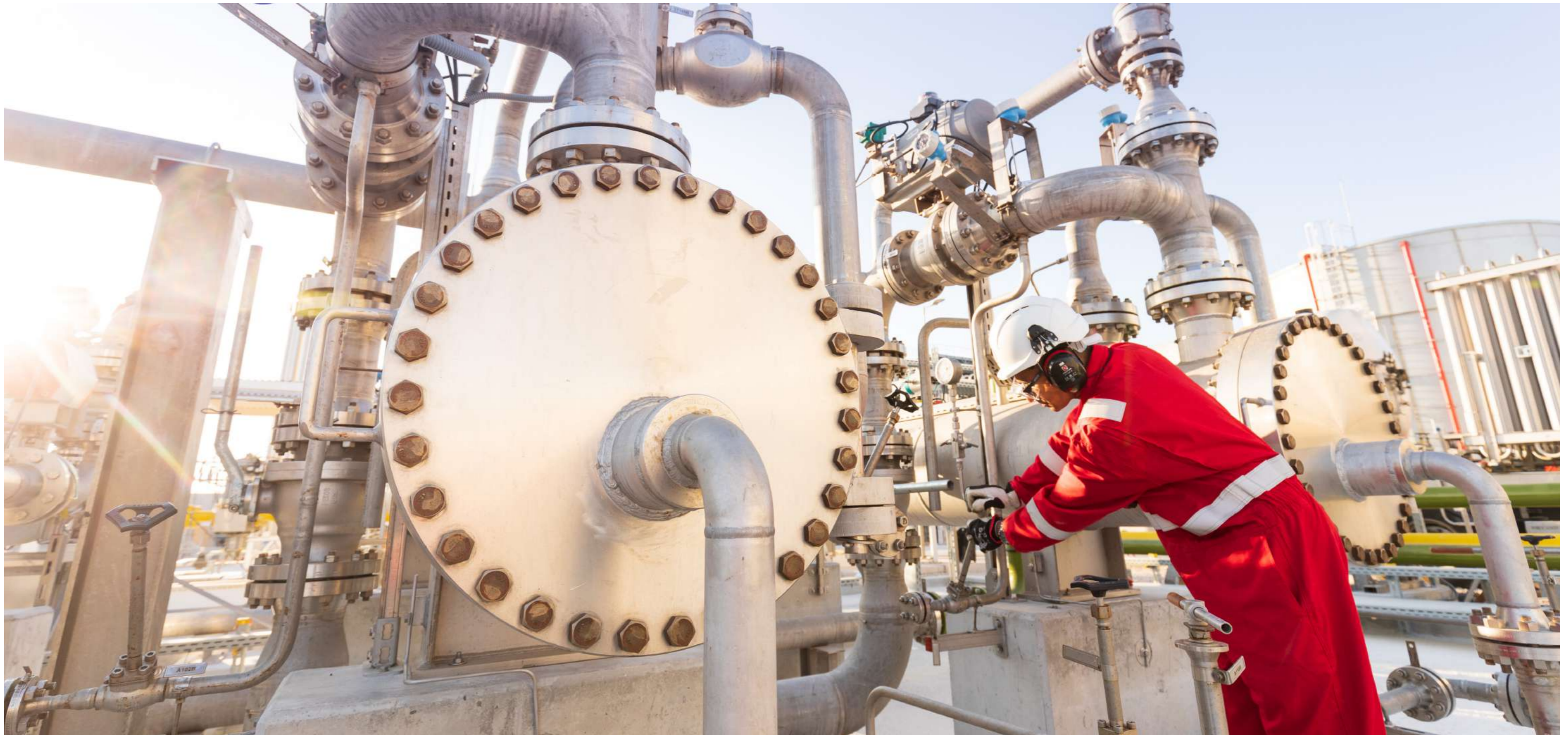
Gibraltar LNG Regasification Terminal – Courtesy of Shell
